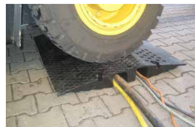
Kabel und Schläuche abgedeckt
